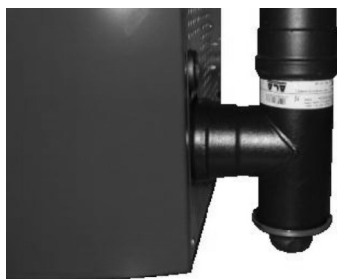
Fig. 28 - Pulizia canale da fumo
